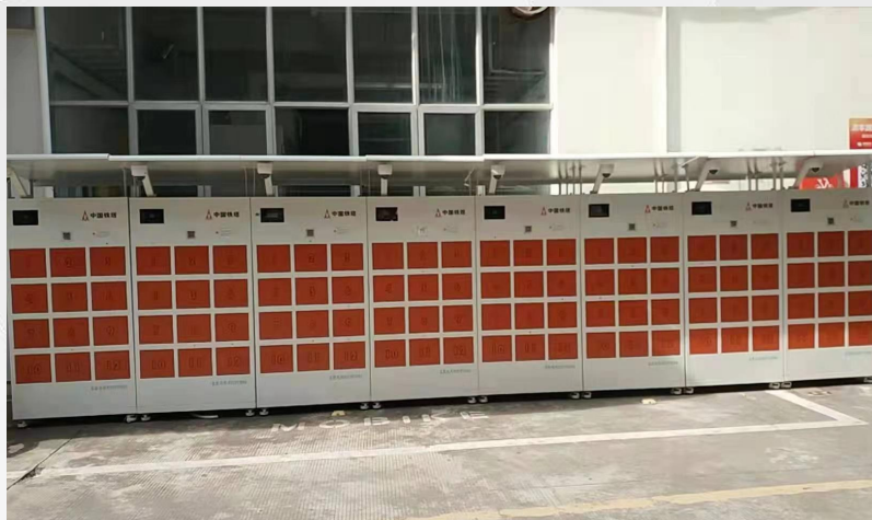
铁塔能源深圳福田电动自行车 充换电场站
