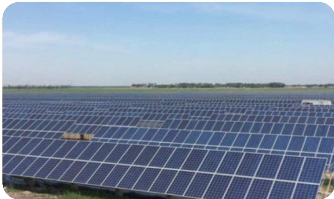
长春光伏地面电站15MW
