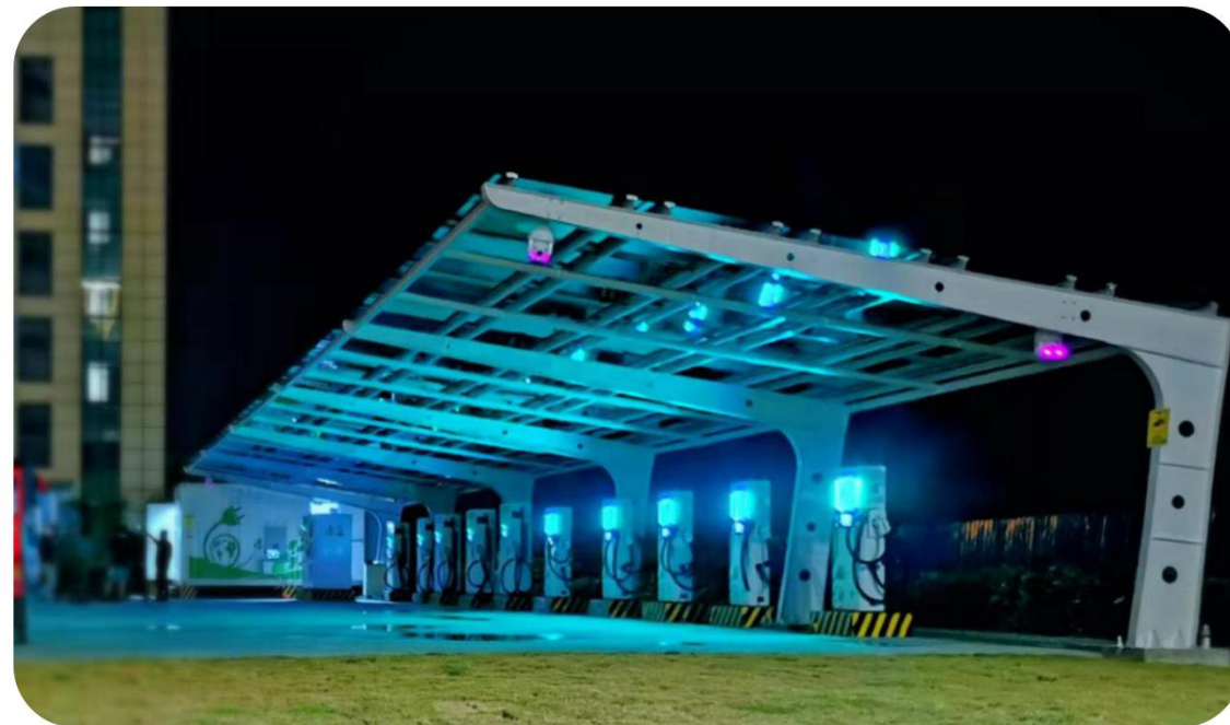
博鳌光储充一体化场站
