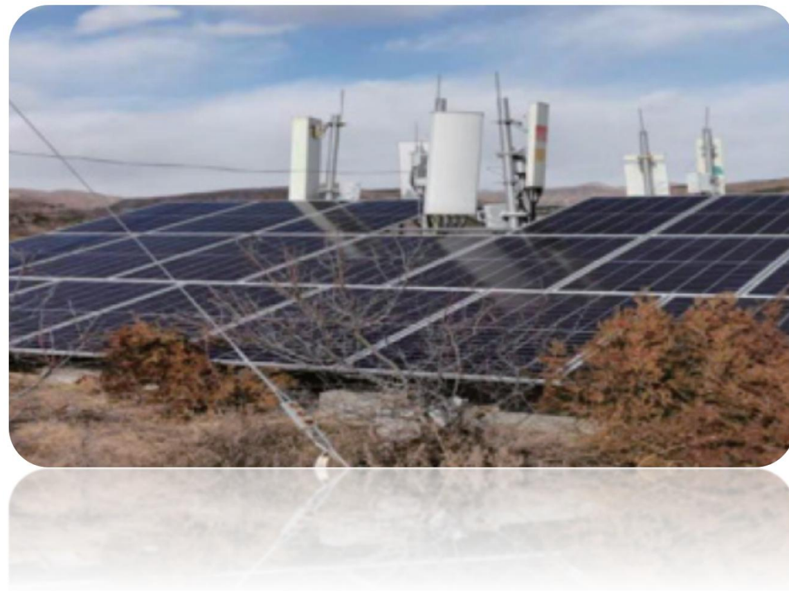
张家口光伏通信基站
